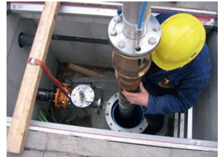
Een installateur hangt een pomp in een open WKO-bron. De oranje leiding loopt richting het gebouw.
